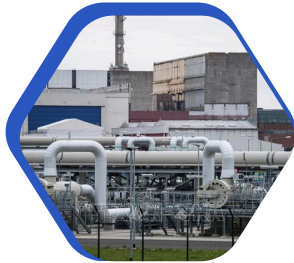
NHÀ MÁY KHÍ, TRẠM CUNG CẤP KHÍ GAS PLANT, GAS SUPPLY STATION
